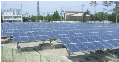
강릉 태양광 발전 시설
