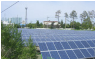
KT 태양광 발전시설
