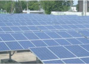
KT 태양광 발전시설
