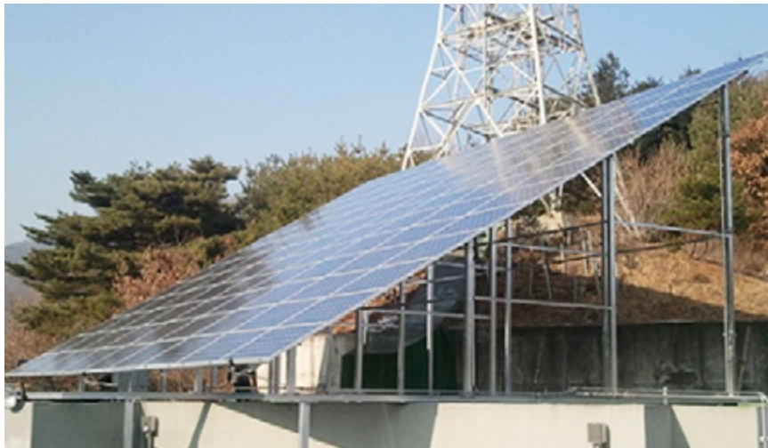
[ kt 강릉수신소 태양광 발전소 현장 ]
